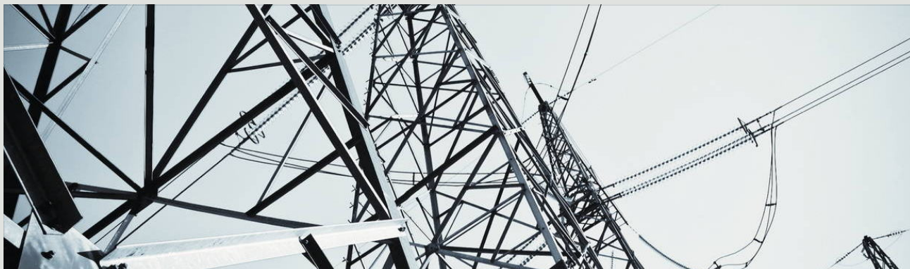
— Опора ЛЭП / порталы
